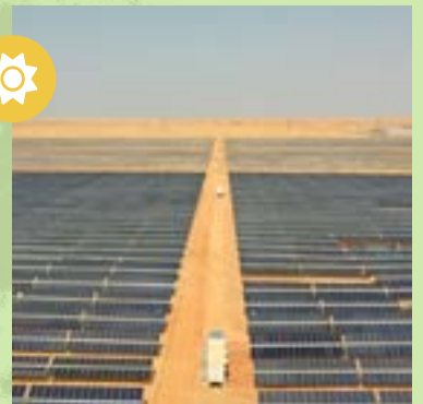
Aeso-Abeso 126 MW - Egypt
