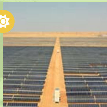
Aeso-Abeso 126 MW - Egypt
